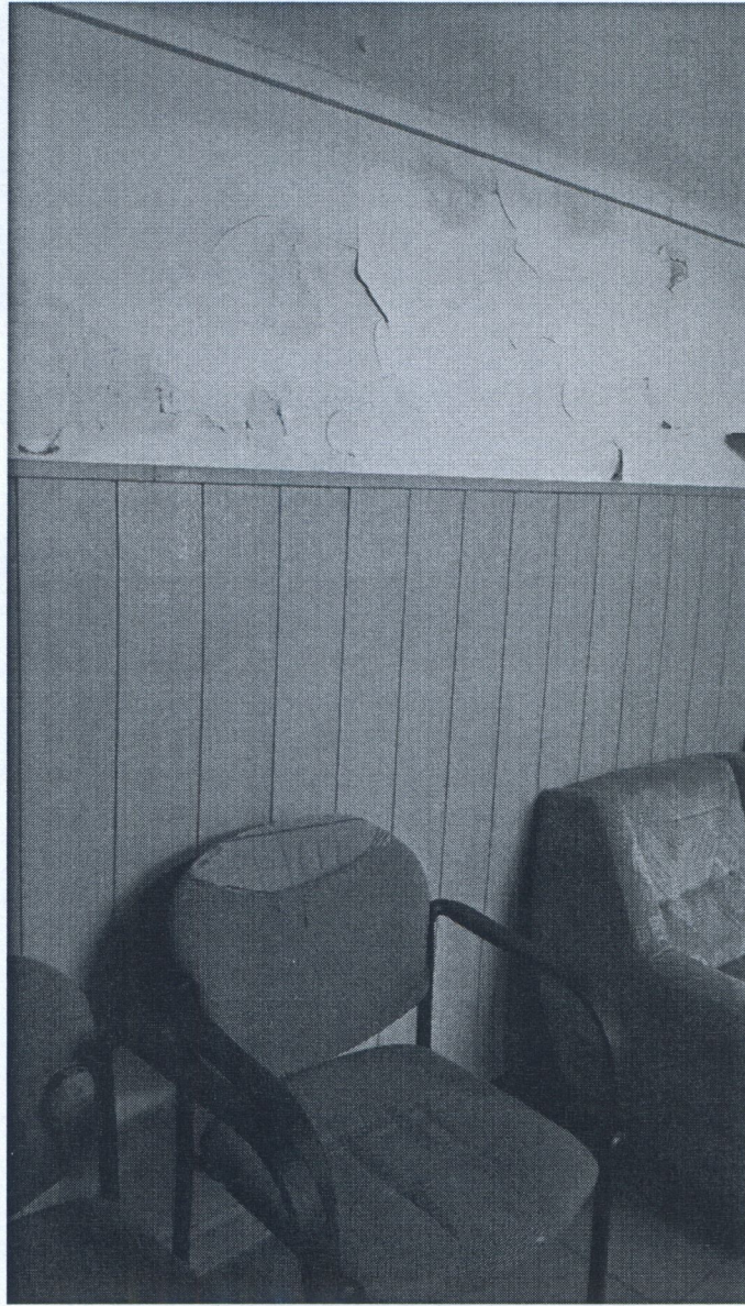
12. kép: omló vakolat és szakadt huzatú szék a személyzeti pihenőben
