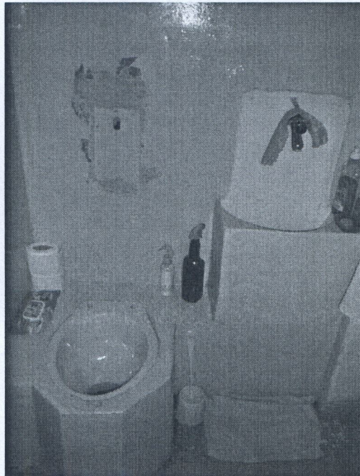
20. kép: Ülőke és tető nélküli körbebetonozott WC-csésze
